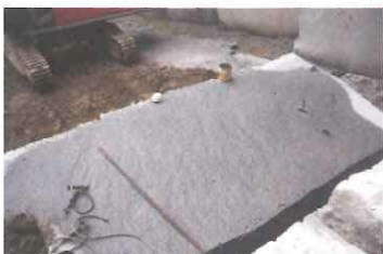
7. ひびを入れた石は大型のユンボで引っかけて倒します。ちなみに重さは約80トン!!
