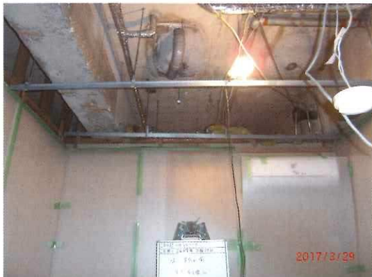
1階「半月の間」天上 配水管
